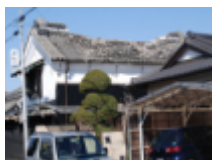
地震による被害
