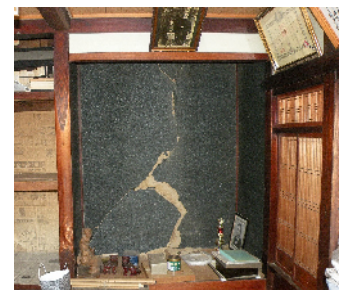
地震で損傷した土壁の例
